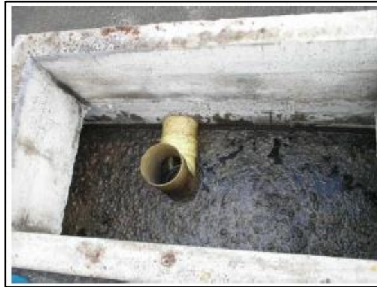
ILUSTRACIÓN 4. FOTOGRAFÍA DE NATAS A REMOVER EN EL TANQUE
