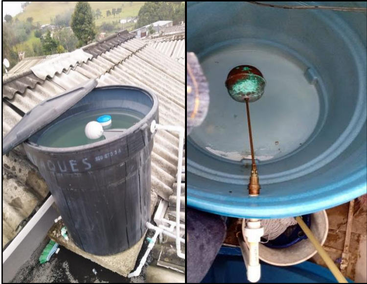
TANQUES DE ABASTECIMIENTO DE AGUA POTABLE
