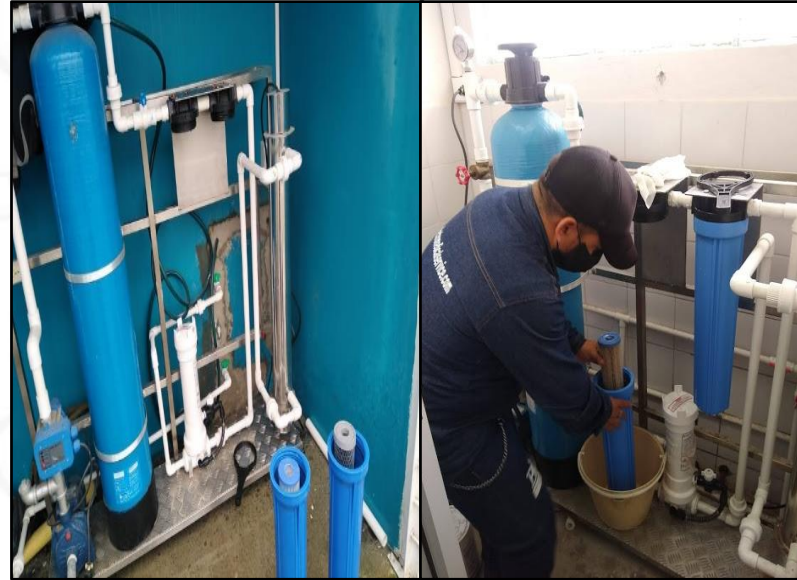
PLANTAS DE TRATAMIENTO DE AGUA POTABLE
