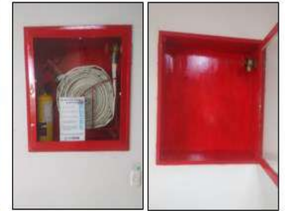
MANT. GABINETES CONTRA INCENDIOS
