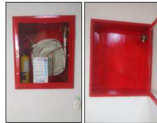
MANT. GABINETES CONTRA INCENDIOS
