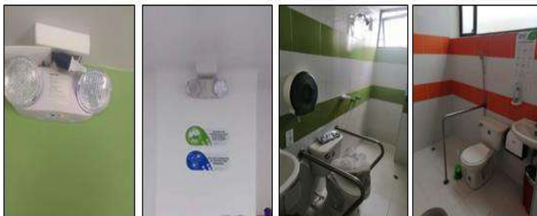
CAMBIO LAMPARAS DE EMERGENCIA
