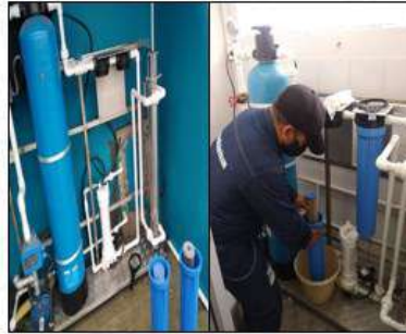
PLANTAS DE TRATAMIENTO DE AGUA POTABLE
